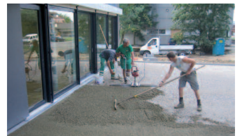
Handeinbau: Abziehen mit der Kruke und Verdichtung mit Balkenvibrator. Mise en place à la main. Egalisation du matériau puis aplatissage avec une compacteuse de petit format.
